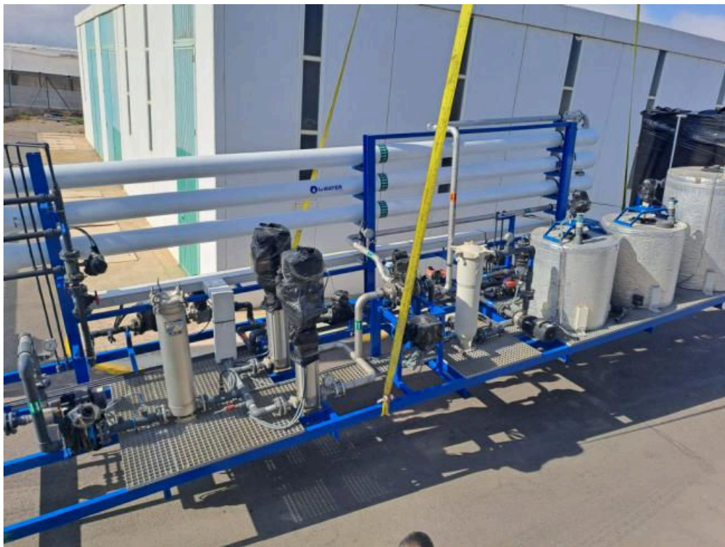
El Ejido instala planta piloto para agua regenerada
